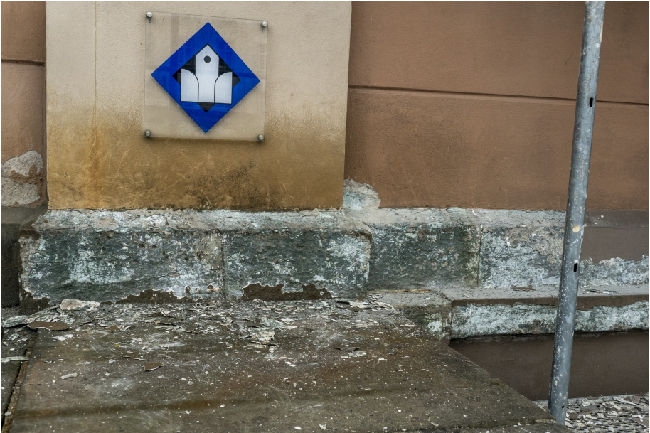
Sanierungsbedarf der Fassade
